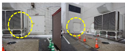
No.1発電機室（外部）
