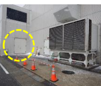
No.2発電機室（外部）
