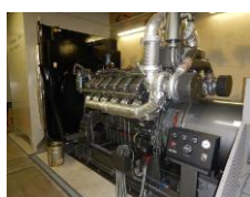
非常用発電機（外観）
