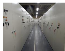
電気室（高圧電気設備）
