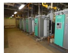
熱源室（ボイラー）
